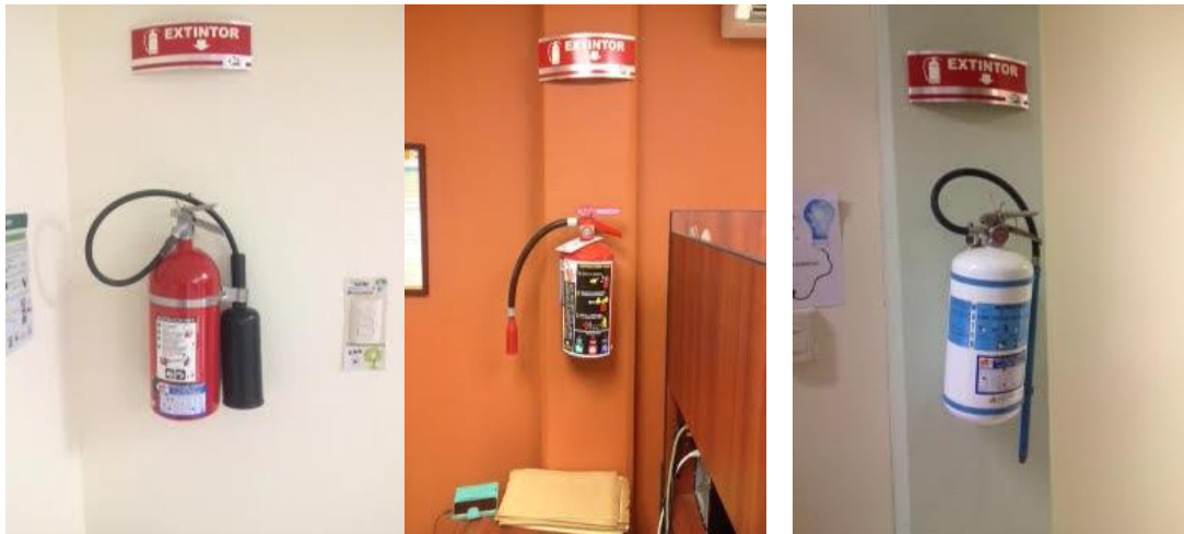
Figura 8 : Extintores en orden de aparición, “GAS BC”, “PQS ABC” y “ESPUMA AC”.
